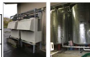
ヒートポンプユニット
